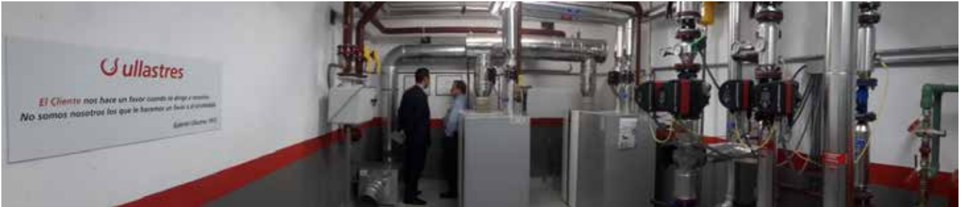
Figura 8.6 Foto panorámica de Central Térmica
