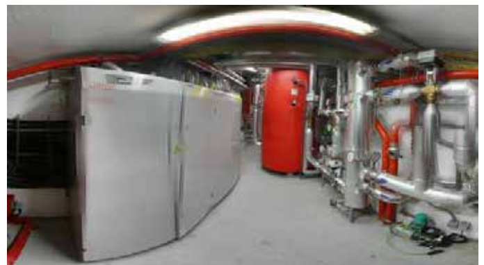
Figura 3.49 Sala técnica de una instalación centralizada de calefacción mediante geotermia y elementos radiantes. Fuente: Eneres, 2019.
