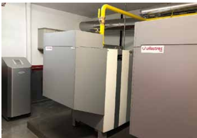
Figura 8.2 Central térmica con calderas de gas de condensación
