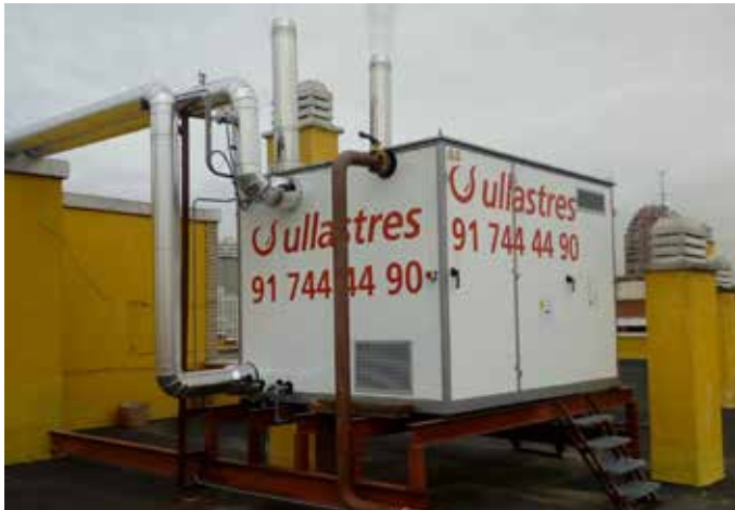
Figura 8.4 Equipo autónomo de gas ubicado en cubierta
