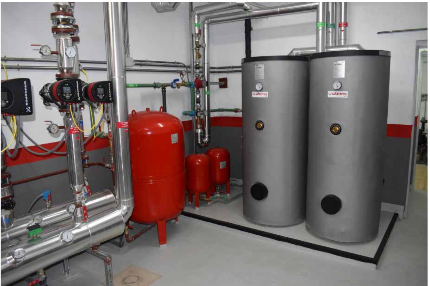
Figura 8.7 Inter-acumuladores de agua caliente sanitaria.
