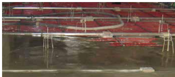
Figura 3.47 Suelo radiante. Fuente: Eneres.
