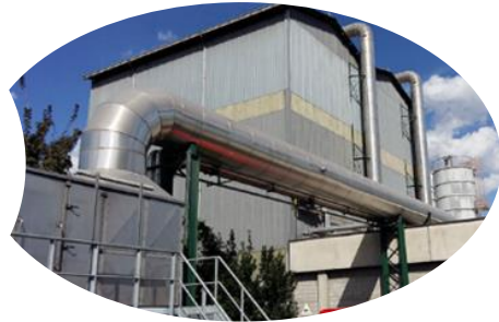
Recuperación de calor
