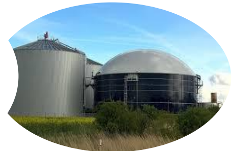
Gas verde (biogás + hidrógeno)
