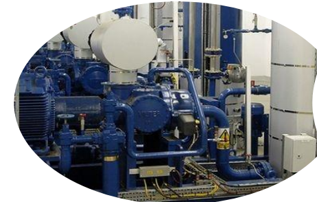
Bombas de calor
