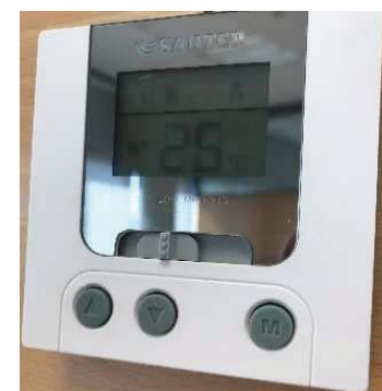
Climatizadores a BMS
