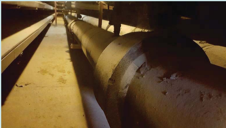
Tuberías de 8" con aislamiento de coquilla elastomérica tipo Armaflex
