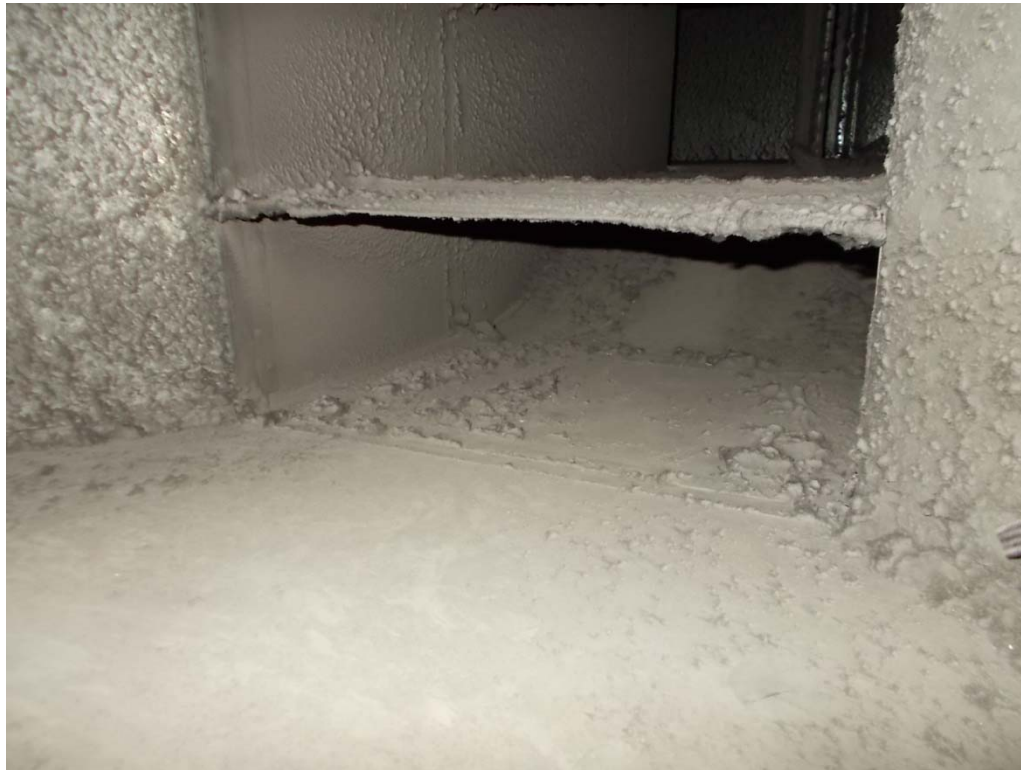
IMAGEN DE INTERIOR DE CONDUCTOS CON ALTO NIVEL DE CONTAMINACION
