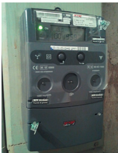
Figura 7. Contador electrónico trifásico.
