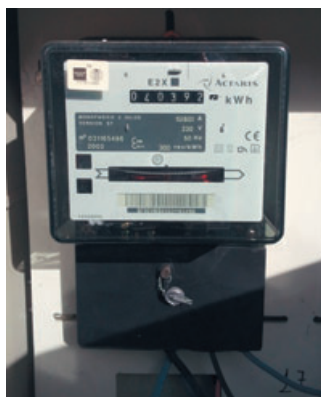
Figura 5. Contador individual en vivienda unifamiliar.
