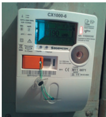
Figura 6. Contador electrónico monofásico para telemedida y telegestión.
