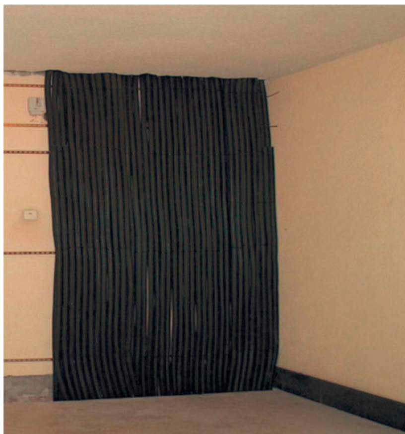
Figura 9. Canalizaciones de derivaciones individuales.
