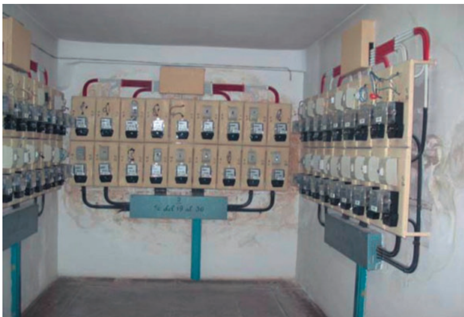
Figura 4. Centralización de contadores.
