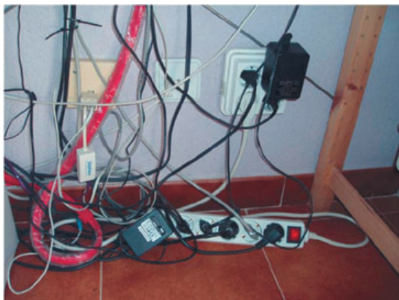
Figura 20. Incorrectas conexiones en enchufes múltiples.
