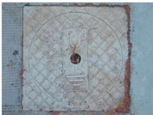
Figura 18. Toma de tierra.
