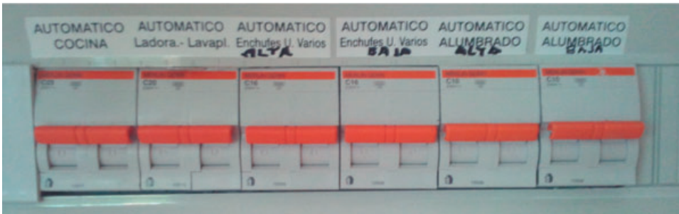
Figura 13. Pequeños interruptores automáticos (PIAs).
