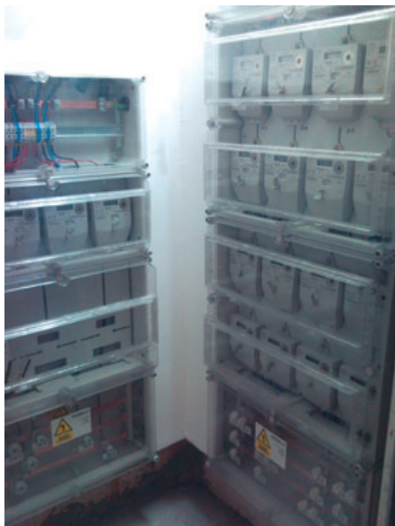
Figura 8. Detalle de centralización de contadores.
