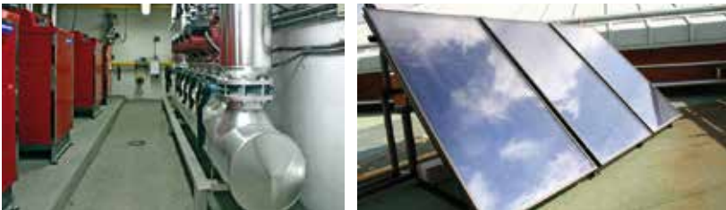
Figura 1.16. Sala de calderas y paneles termosolares. Fuente: Endesa.
