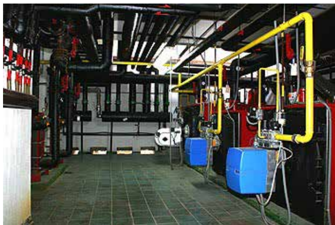
Foto 1.11. Sala de calderas.
