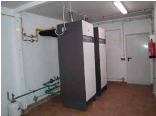
Foto 11.1. Sala de calderas reformada y resuelta con estos generadores semi-instantáneos de condensación.
