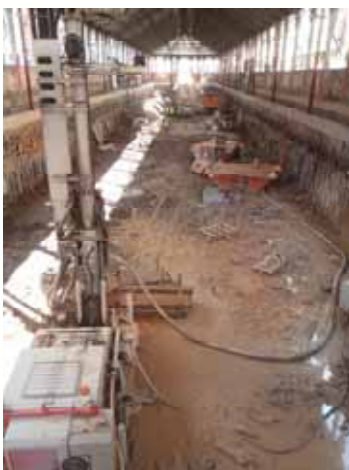
Figura 3. Instalación geotérmica en mercado histórico de Valladolid.
