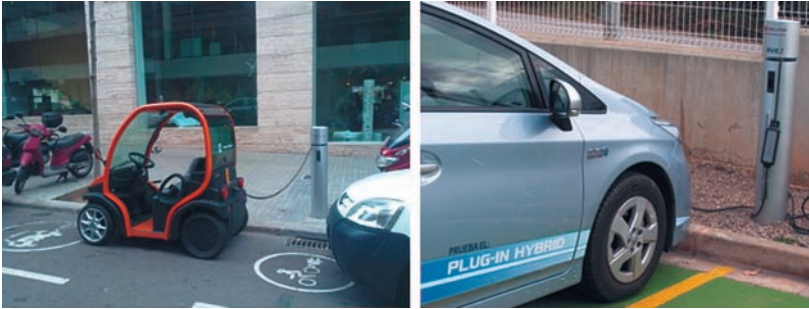
Figura 4. Vehículos eléctricos cargando en modo 1 y 2 con toma schuko.
