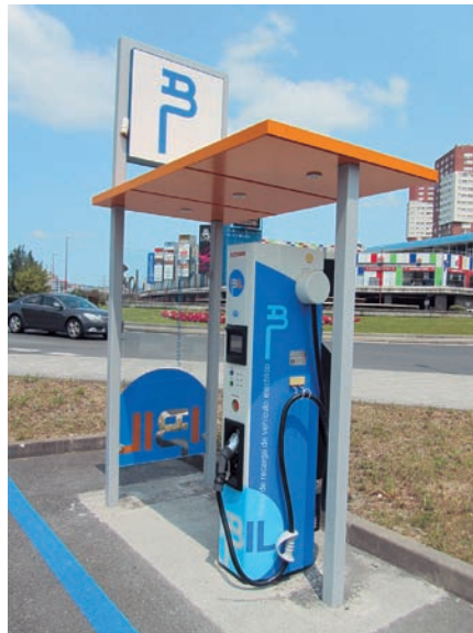
Figura 2. Instalación de carga rápida (modo 4).
