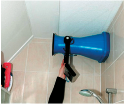
Foto 6.1. Equipo de medición de caudal con pérdida de presión compensada con un alcance, por ejemplo, entre 15 y 225 m 3 /h para aplicaciones en viviendas (UNE12599).
