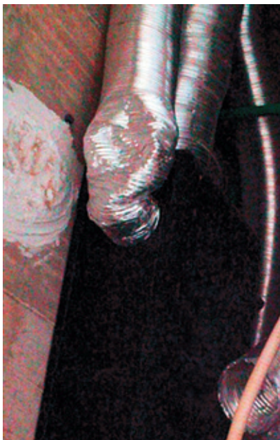
Foto 6.8. Unidad de extracción de aire mal conectada debido a: disminución de la sección, curva forzada e instalación en tubo flexible sin estirar y de más de 0,5 m.
