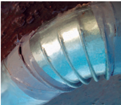
Foto 6.7. Fuga de aire que provocará: disminución del caudal, menor eficiencia energética y ruido.
