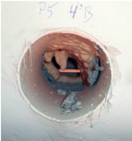
Foto 6.6. Yeso, aislamiento y escombros en el tubo de admisión de aire de una unidad descentralizada en fachada.
