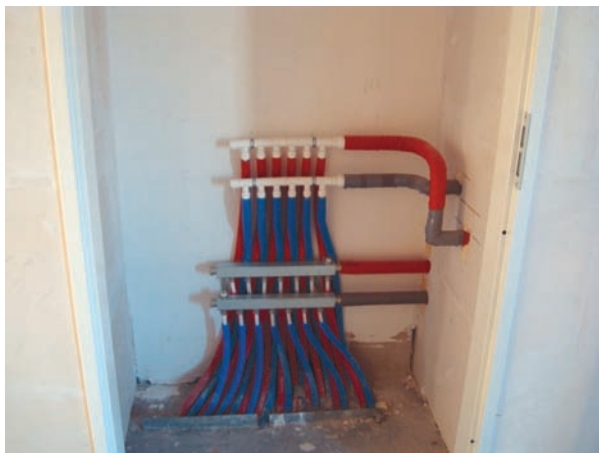
Foto 7.2. Instalación por colectores.
