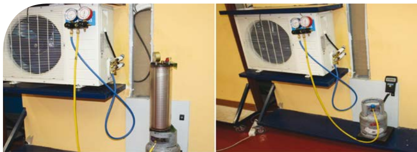
Foto 13. Carga de refrigerante por volumen o peso.
