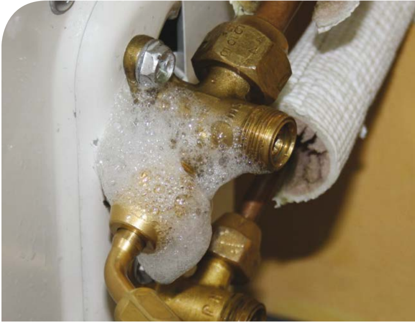
Foto 5. Fuga en una instalación frigorífica.
