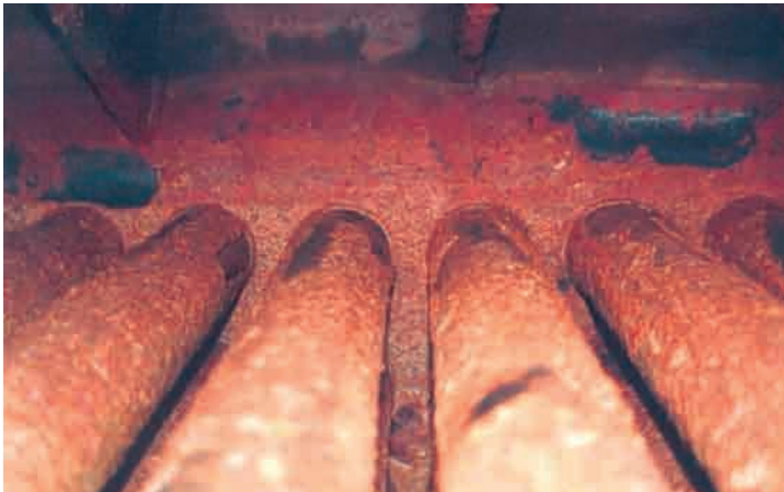
Foto 3.1. Ejemplo incrustaciones en caldera de vapor.
