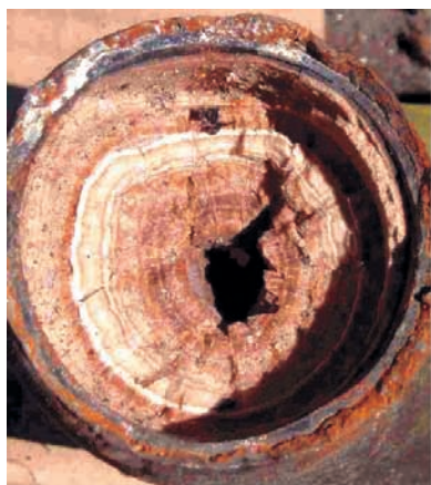
TUBERÍA COLMATADA CON SEDIMENTOS CALCÁREOS
