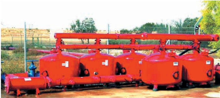
CABEZAL DE FILTRACIÓN DE ARENA
