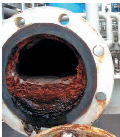
TUBERÍA COLMATADA CON BIOCAPA
