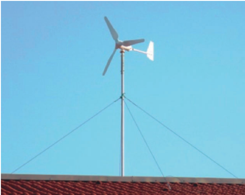
Figura 2. Aerogenerador montado sobre torre atirantada. Fuente: Garbitek.
