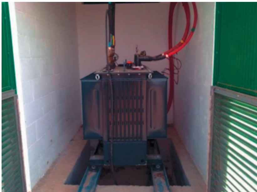
Figura 8. Centro de transformación. Tareas de mantenimiento del transformador. Fuente: Electrica Wind, S.L.
