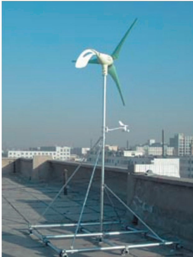
Figura 4. Aerogenerador Airdolphin de 1 kW instalado en techo de edificio. Fuente: CIEMAT.
