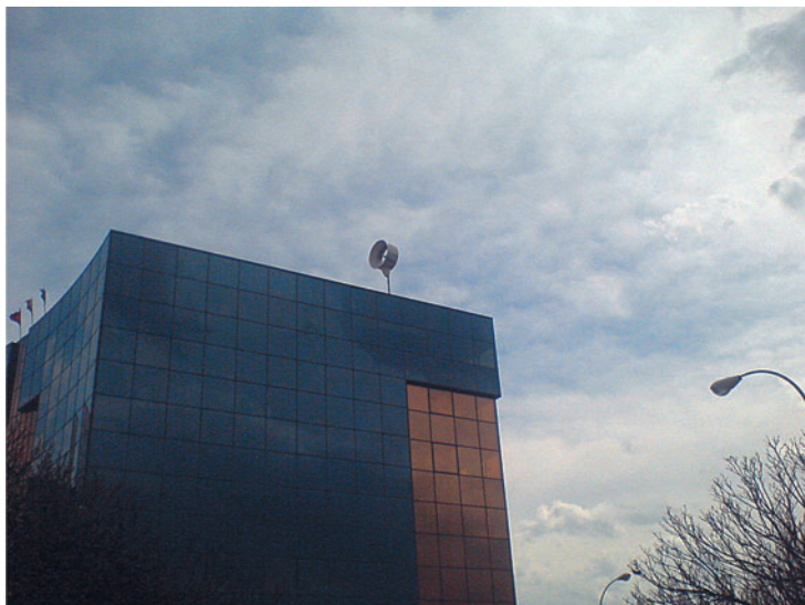
Figura 3. Aerogenerador Donqi 1.75 kW (2 m diámetro) instalado en cubierta de edificio en Pamplona. Fuente: CIEMAT.
