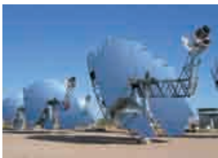
Foto 7. Disco parabólico + motor Stirling. Fuente: Archivo RENOVETEC.
