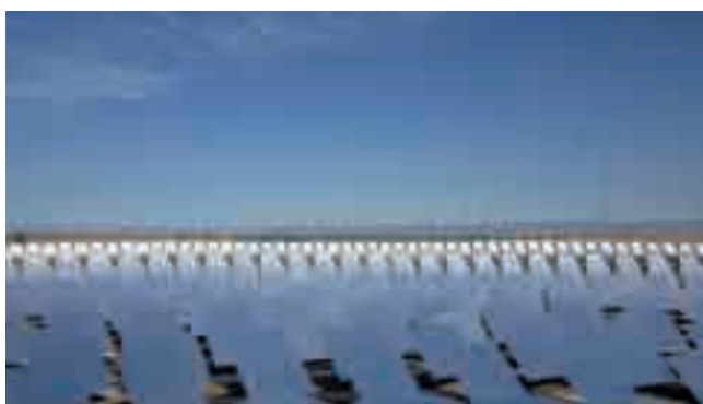
Foto 3. Campo de heliostatos en operación.
