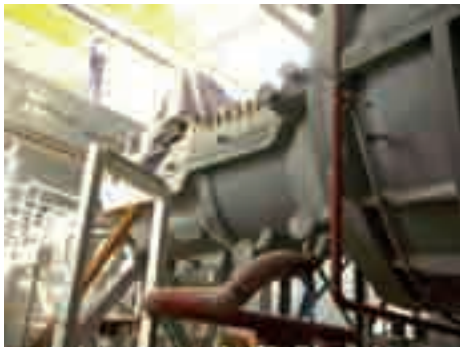
Foto 4. Turbina de vapor. Fuente: Archivo RENOVETEC.
