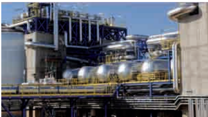
Foto1. Intercambiadores en la planta Andasol I.
