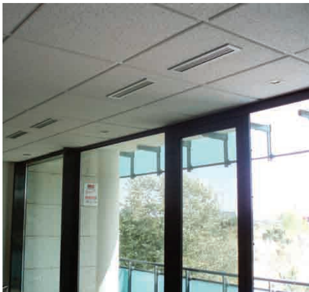
Foto A2.5. Sistema de distribución de climatización por rejillas.
