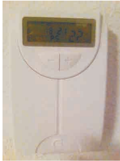
Foto 5.6. Termostato de vivienda con temperaturas adecuadas.
