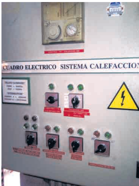
Foto 2.3. Vista de un cuadro eléctrico durante la auditoría de una instalación.
