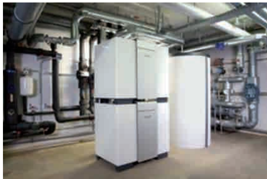
Foto A1.11. Instalación geotérmica con equipos Stiebel Eltron.
