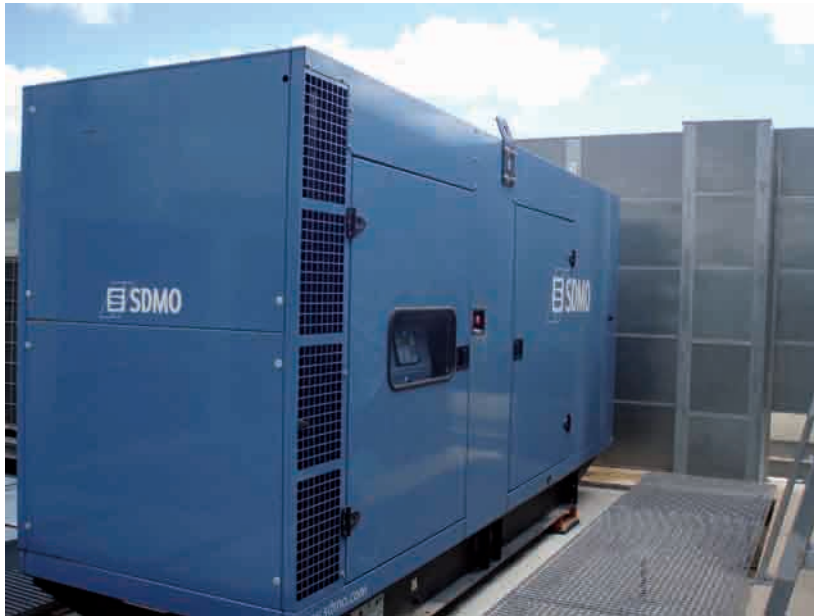
Foto A1.6. Ejemplo de grupo electrógeno.
