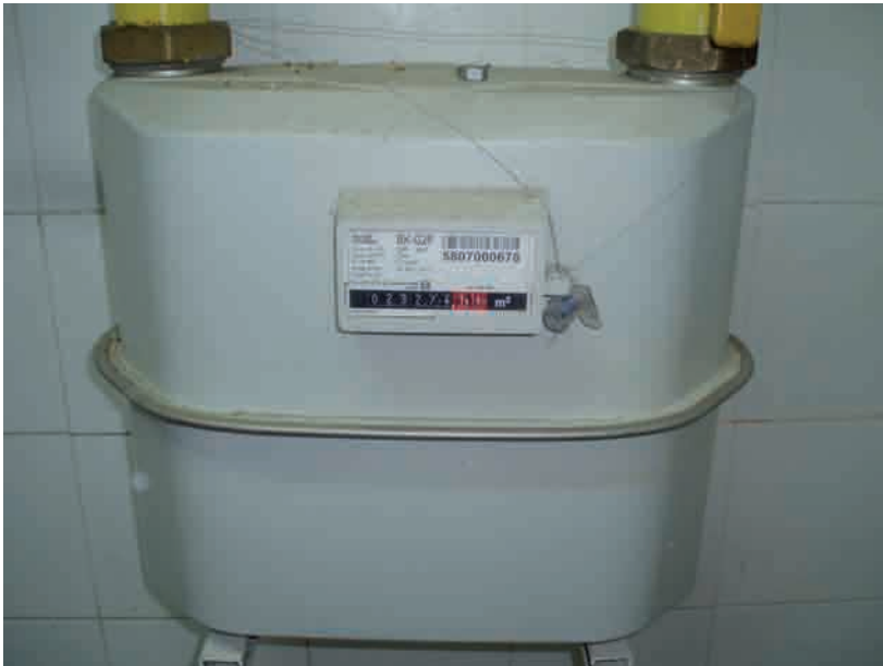
Foto 5.4. Contador de gas en complejo residencial.
