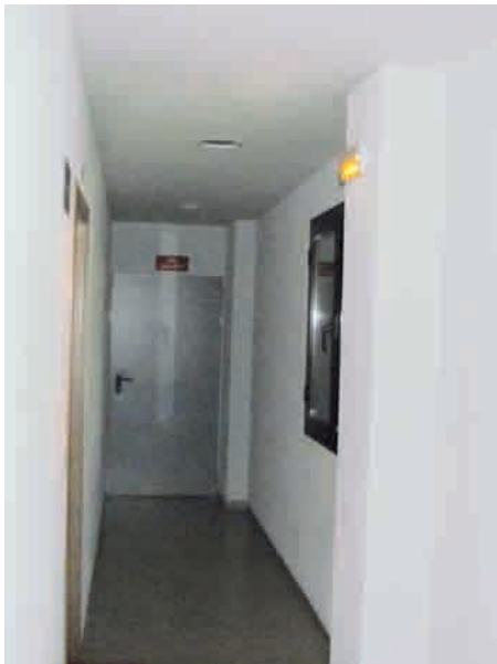
Foto 2.7. Iluminación interior de emergencia en una comunidad en la zona de La Tenerife en Pinto.
