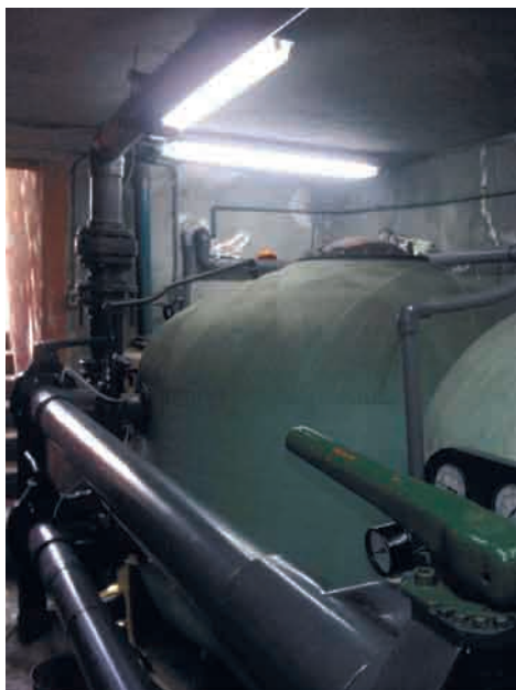
Foto 2.6. Vista general de sala técnica para piscina en comunidad de vecinos perteneciente al término de Alcobendas.
