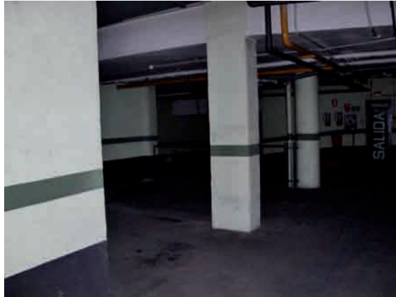
Foto A3.3. Parking iluminado con niveles mínimos en ausencia de tráfico.
