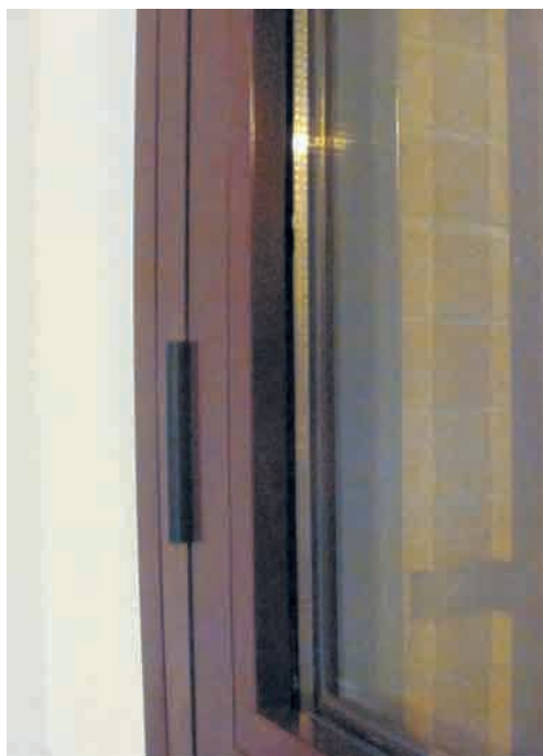
Foto 5.5. Vidrios con rotura de puente térmico en inmueble de San Sebastián de los Reyes.
