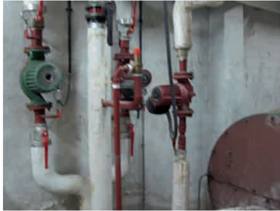
Foto 5.1. Detalle de sala de calderas con posibilidades de ser objeto de sustitución.
