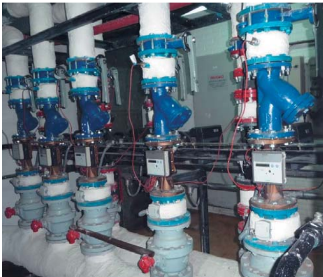
Figura 7.10. Fotografía de contadores de calorías instalados en 5 circuitos.
