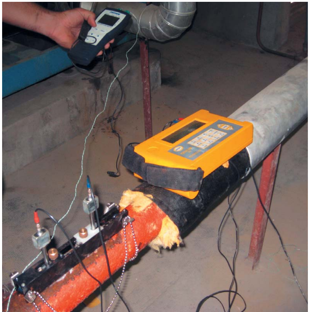
Figura 7.11. Medida de la energía térmica útil proporcionada por una enfriadora al circuito hidráulico.
