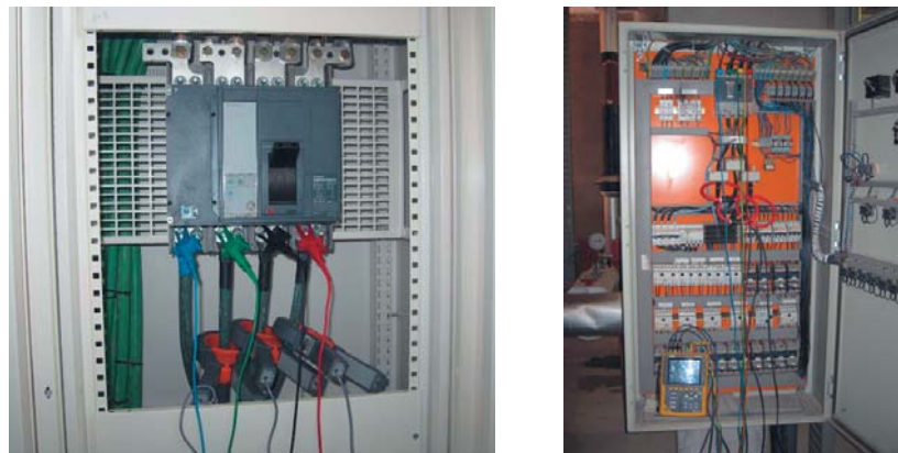
Figura 7.5. Conexión de analizador de redes eléctricas a interruptor general del cuadro.
