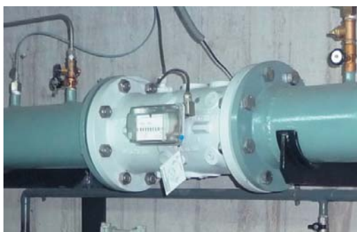
Figura 7.8. Fotografía de contador de gas de la compañía.
