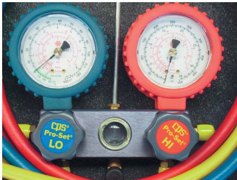
Figura 3.2. Manómetros mecánicos. Puente de manómetros para la medida de las presiones de alta y baja en máquinas frigoríficas.
