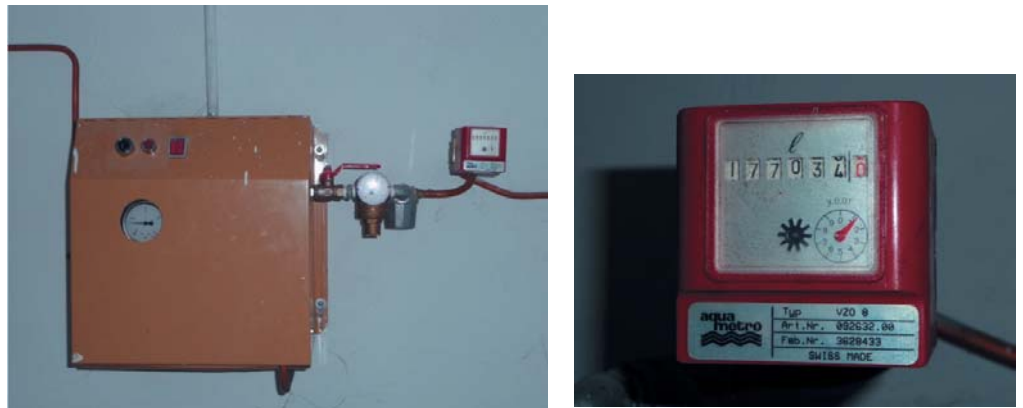
Figura 7.9. Fotografía de contador de gasóleo C.
