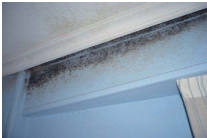
Fotografía 6. Crecimiento de mohos en el interior de las viviendas.
