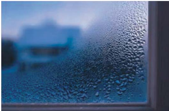
Fotografía 5. Condensaciones en el interior de las viviendas.
