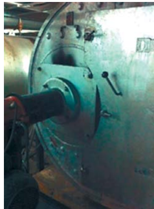
Figura 2. Caldera con junta deteriorada.
