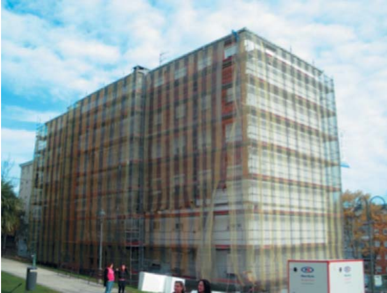
Fotografía 3. Andamios colocados por el exterior de los edificios permiten la realización rápida de los trabajos necesarios.
