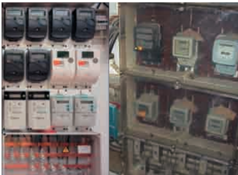
Figura 3. Ejemplo de cuarto de contadores. Fuente: IBERDROLA, S.A.
