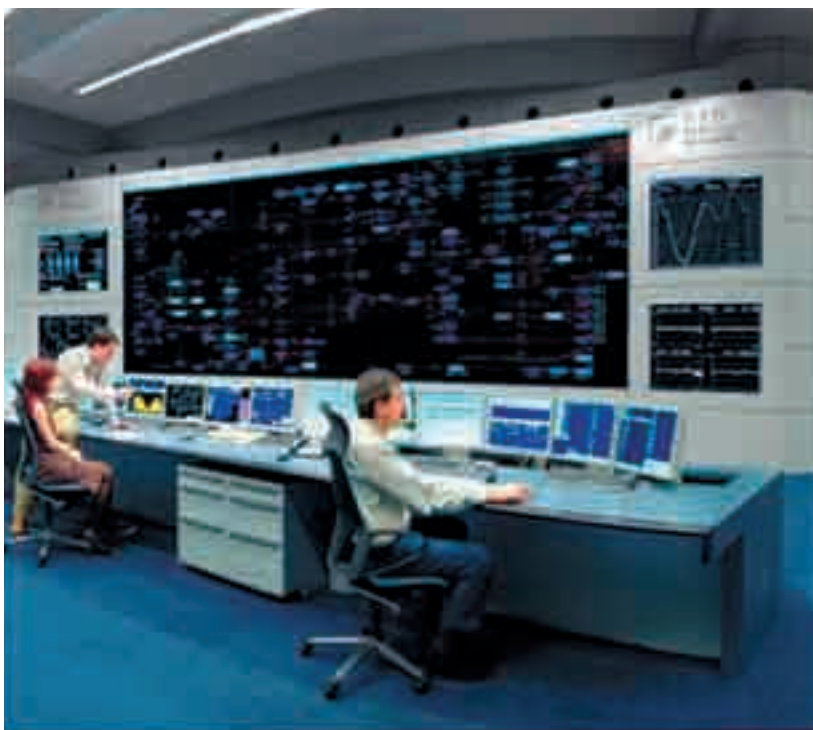
Figura 2. CECOEL (Centro de Control Eléctrico). Fuente: REE.
