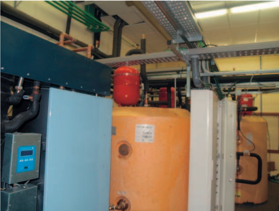
Foto 2. Sala de máquinas del BPFSG. Fuente: ARFRISOL.
