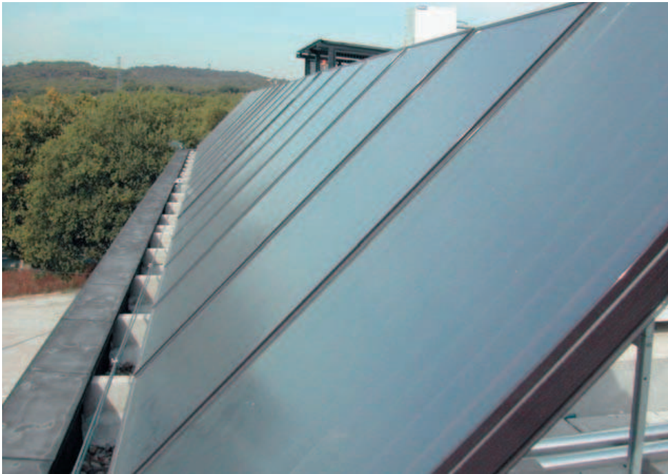
Foto 3. Campo de captadores solares térmicos.
