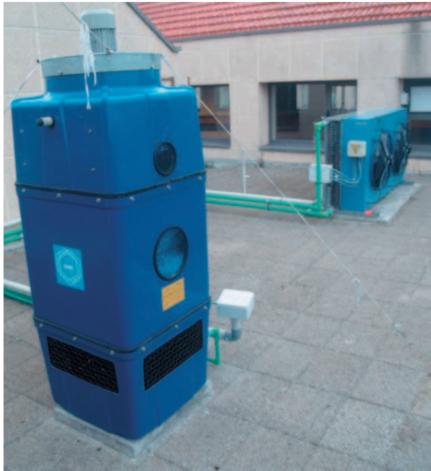
Foto 3. Sistemas de disipación. Fuente:ARFRISOL.
