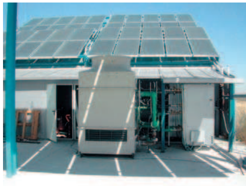
Foto 2. Torre de refrigeración y a la derecha las unidades Yazaki de refrigeración por absorción. Fuente: Absorsistem.
