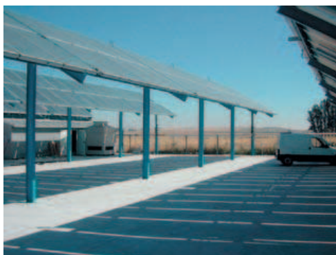
Foto 1. Distribución de paneles solares. Fuente: Absorsistem.
