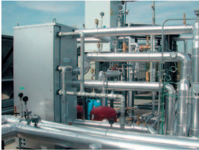
Foto 1. Planta enfriadora Yazaki, torre de enfriamiento y tuberías del circuito hidráulico.
