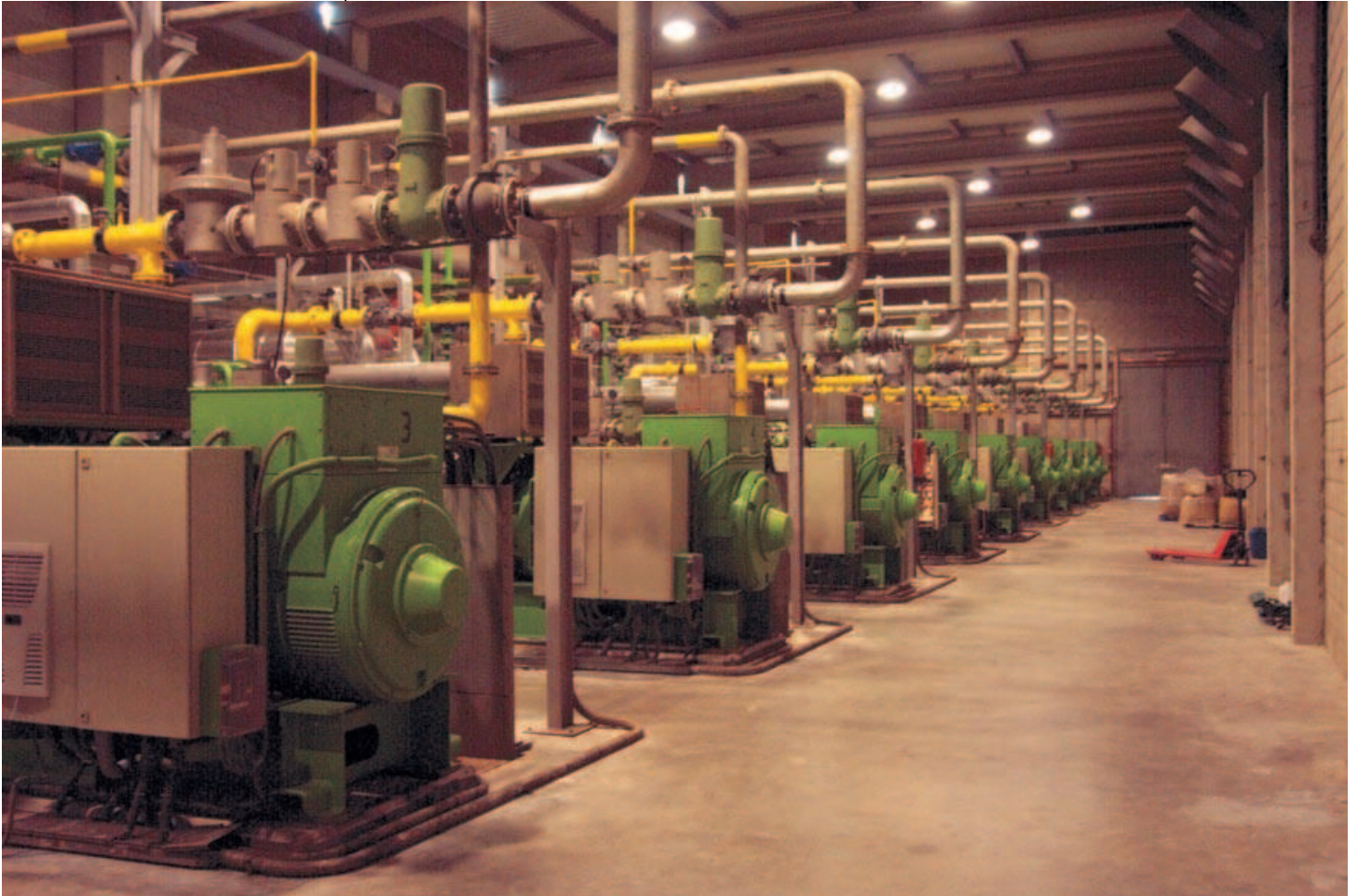
Foto 6.7. Sala de motores.
