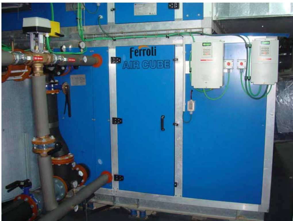
Foto A2.6. Equipo climatizador (Fuente: Ferrolli).
