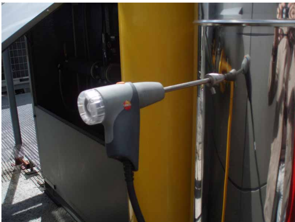
Foto 3.6. Analizador de gases en caldera (Fuente: Geoter).
