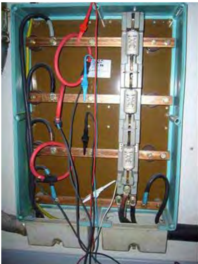
Foto 7.5. Equipo de medida en la acometida eléctrica.
