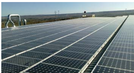
Instalaciones fotovoltaicas en el complejo de tratamiento integral de RCD en El Molar
