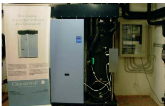
Sala de máquinas
