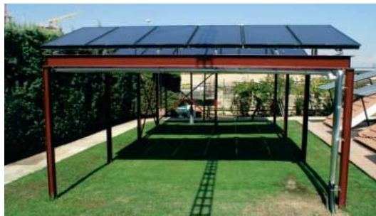
Detalle del campo solar
