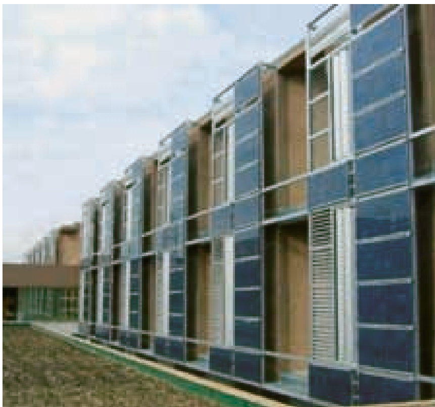
Foto 2. Instalación fotovoltaica integrada.
