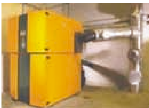
Foto 16. Caldera de pellets de 150 kW.
