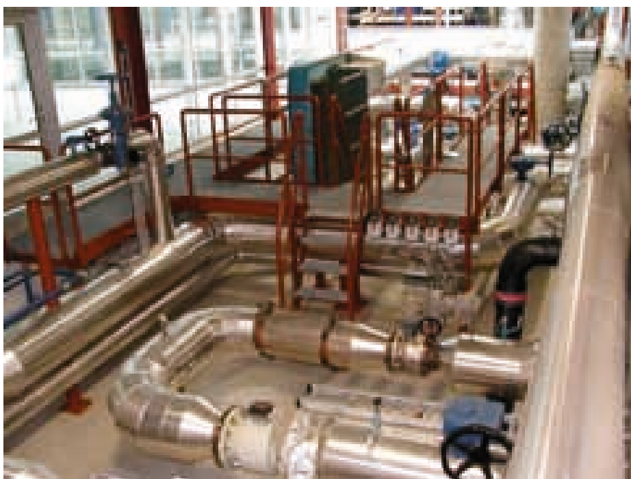
Foto 2. Central binaria en Islandia.
