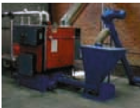
Foto 15. Caldera de pellets (admite otros combustibles) de 250 kW de potencia.
