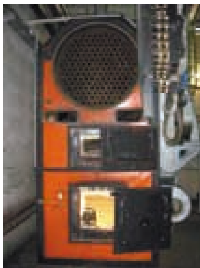
Foto 4. Caldera de parrilla abierta (1.500 kW).
