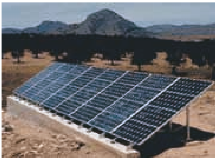
Foto 1. Instalación fotovoltaica aislada.
