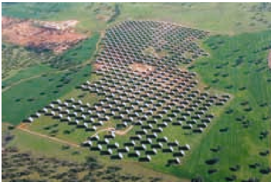
Foto 4. Instalación fotovoltaica en suelo.
