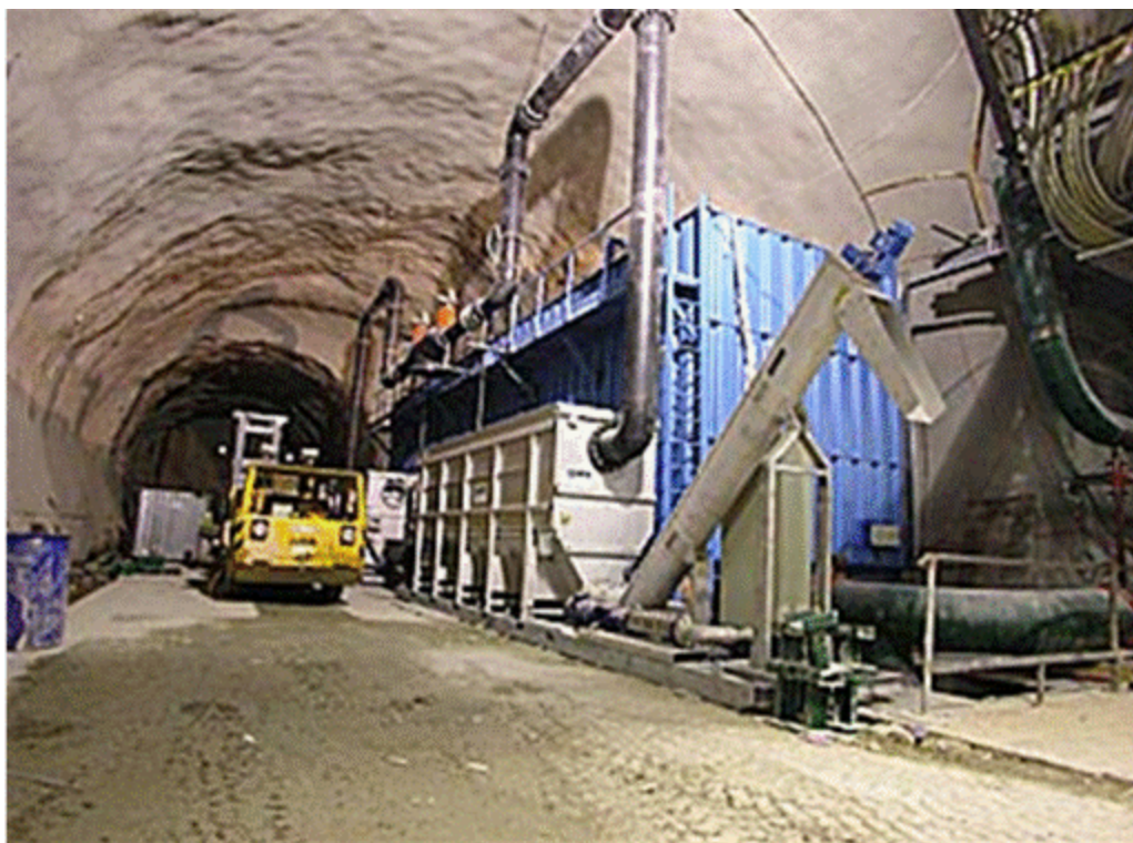
Foto 4.9. Galería con decantador y depósito para el agua subterránea drenada por el túnel de Gotthard (Suiza). (Fuente: Site Geothermie-Perspectives de l'ADEME et du BRGM ).
