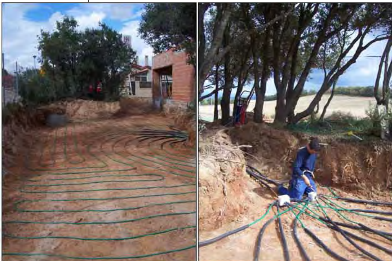
Foto 4.1. Red de captadores horizontales y unión de tubos. (Fuente: www.instalacionesalegre.com ).
