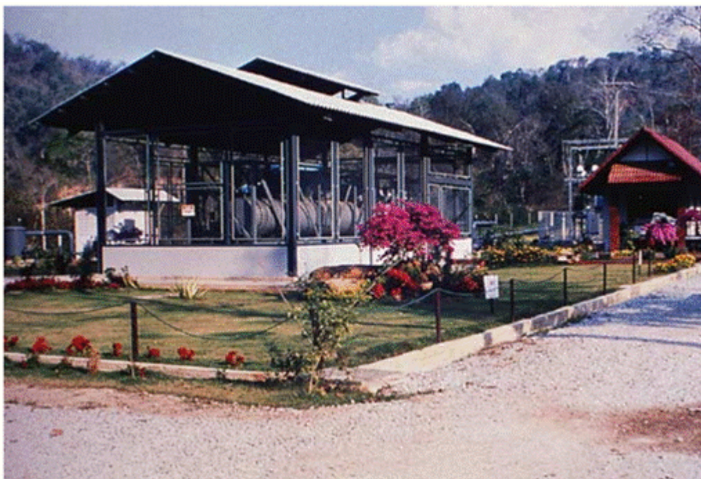
Foto 6.3. Planta eléctrica de ciclo binario y pequeña potencia en Fang, Tailandia. Presenta un mínimo impacto visual y se integra en el paisaje con armonía. (©2000 Geothermal Education Office).
