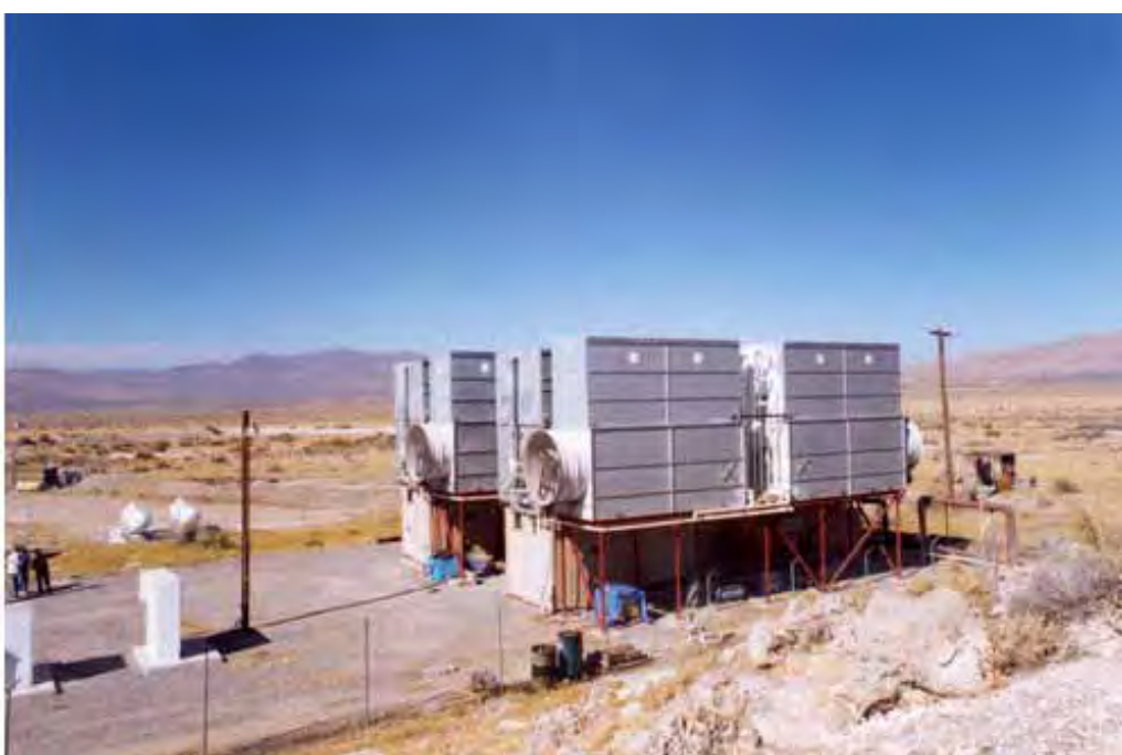
Foto 6.2. Planta eléctrica de ciclo binario en Wendell-Amadee, California. Se aprecia su estructura modular. Su funcionamiento es automático, vigilado por control remoto. (©2000 Geothermal Education Office).
