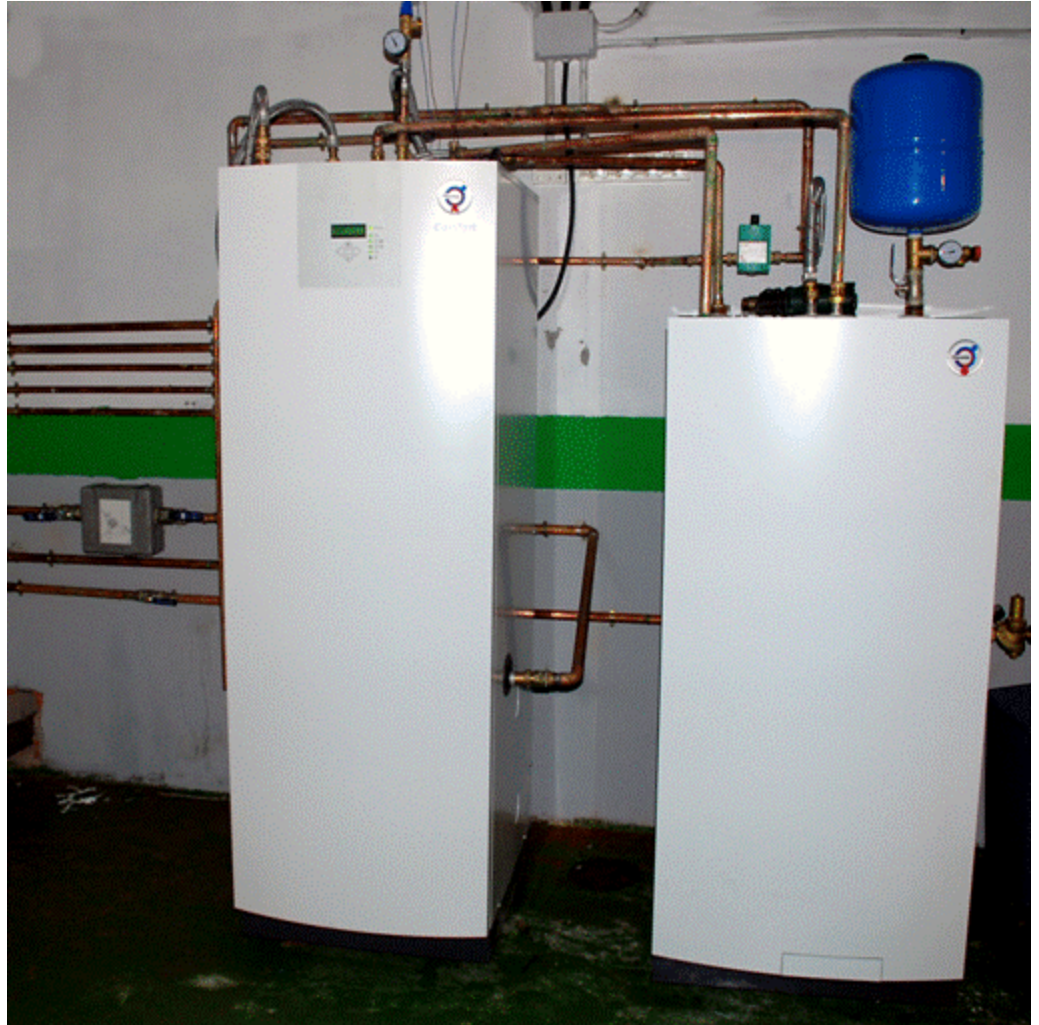
Foto 4.6. Conexión de tubos captadores a bomba de calor geotérmica en la sala de calderas de una vivienda. Salida de tuberías de cobre a aparatos distribuidores. (Fuente: Girod Geotermia ).
