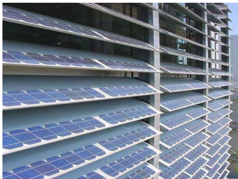
Foto 10. Instalación fotovoltaica integrada en lamas.
