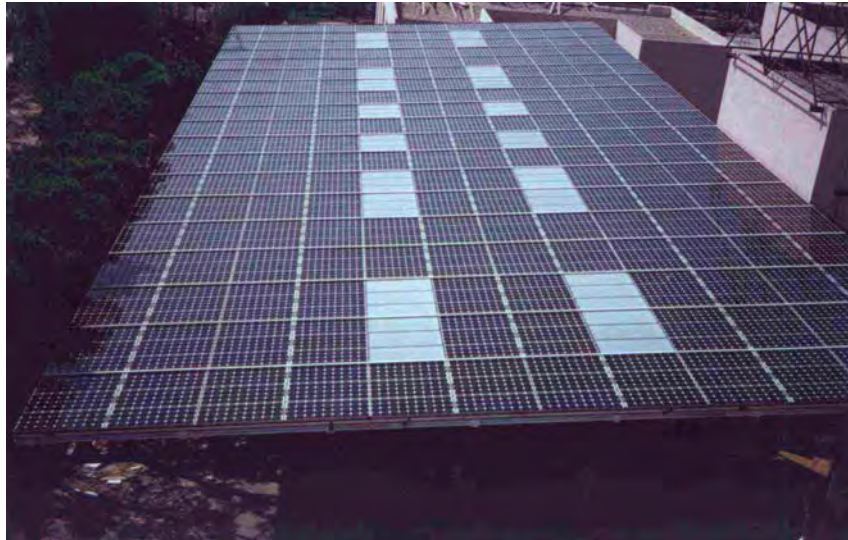
Foto 9. Instalación fotovoltaica integrada en cubierta.
