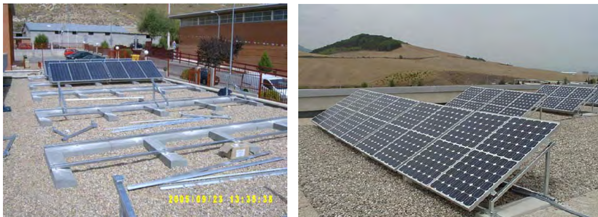
Foto 6. Sistema fotovoltaico sobre tejado plano no perforable.
