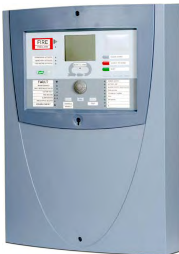
Figura 11. Central de Detección Automática de Incendios, FX.
