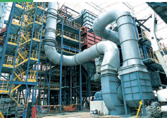
Instalación de EHN en Sangüesa (Navarra) para producción de electricidad. Opera a partir de la combustión de la paja de cereal.
