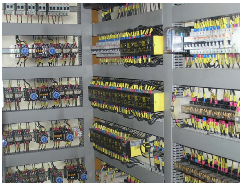
Foto 2. Cuadro eléctrico en el interior de un edificio.
