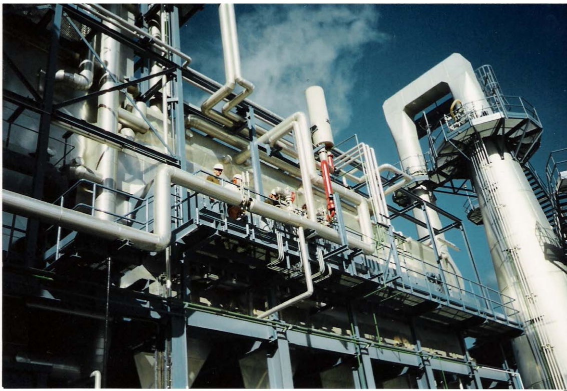
Foto 2. Caldera de recuperación de una planta incineradora. (Fuente: L. Mtz. Centeno – Planta de Melilla).
