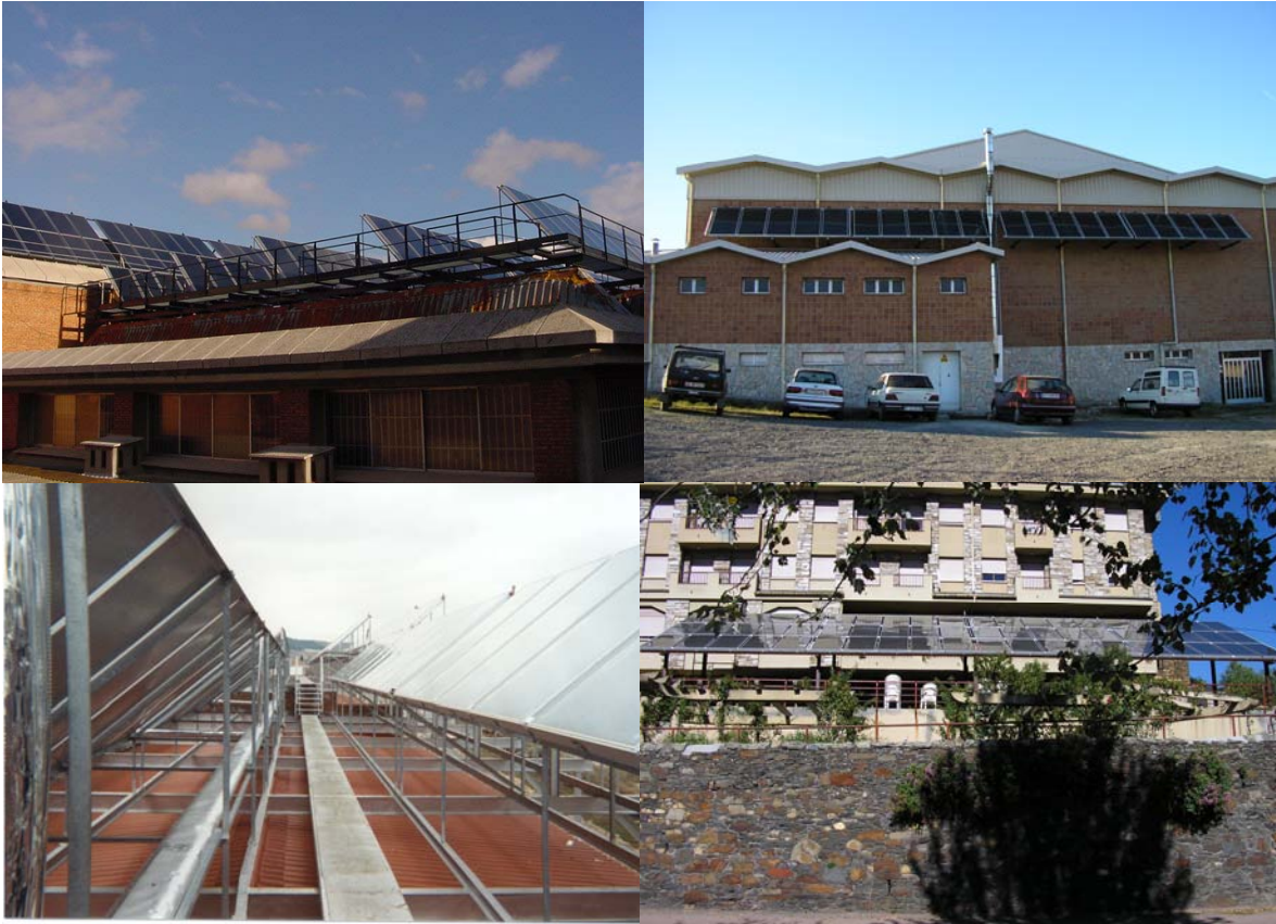
Foto 8. Instalaciones solares térmicas: Polideportivo Municipal en Valladolid, Polideportivo Municipal de Fabero, Centro Asistencial en Palencia y Residencia en Bemibre.
