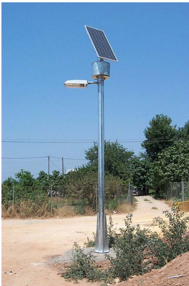
Foto 4. Farola Solar, en el Camino de la Reina, perteneciente al proyecto “Sevilla Ciudad Solar”.
