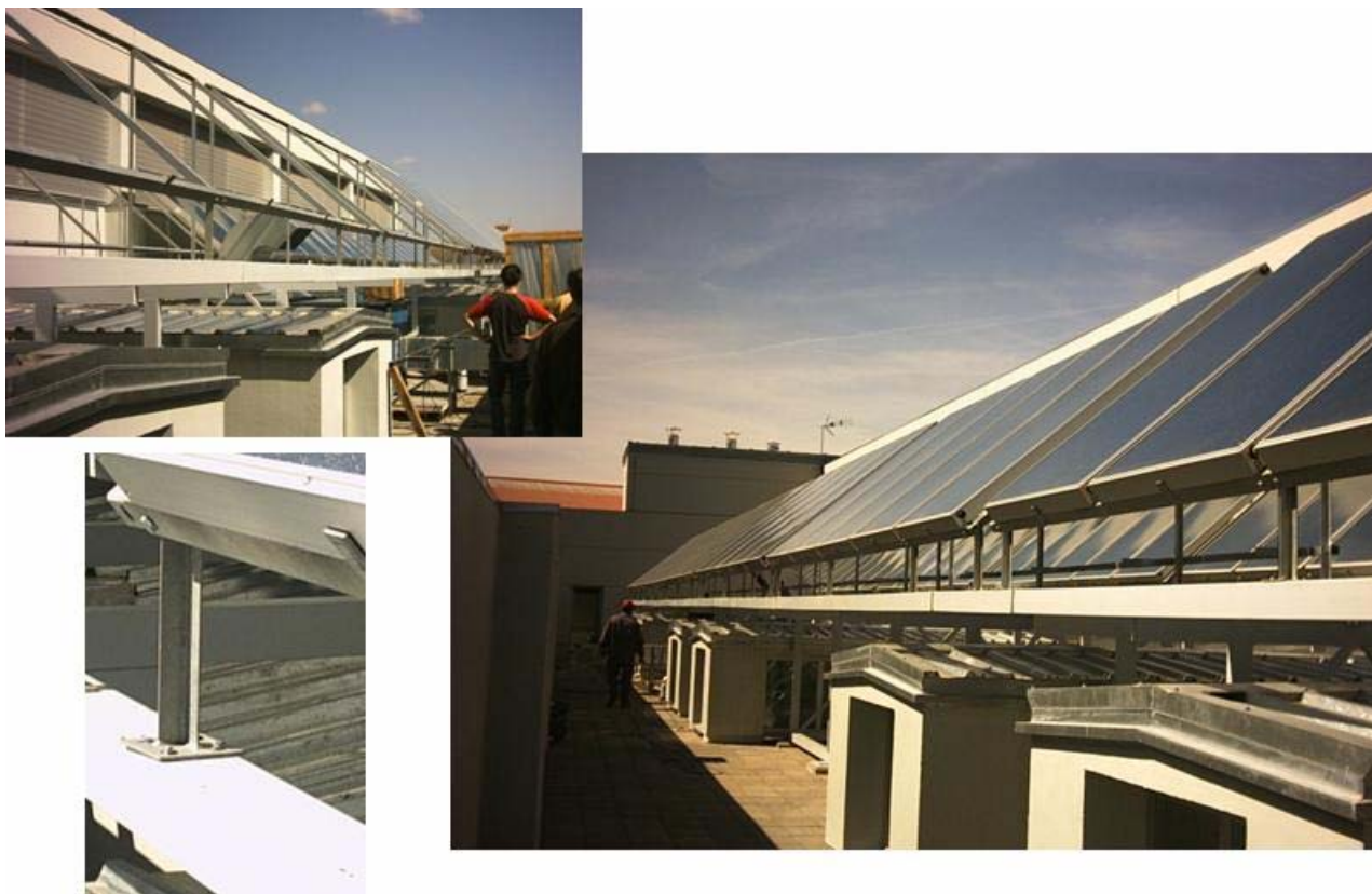
Foto 7. Instalación de la piscina municipal de Almazán.
