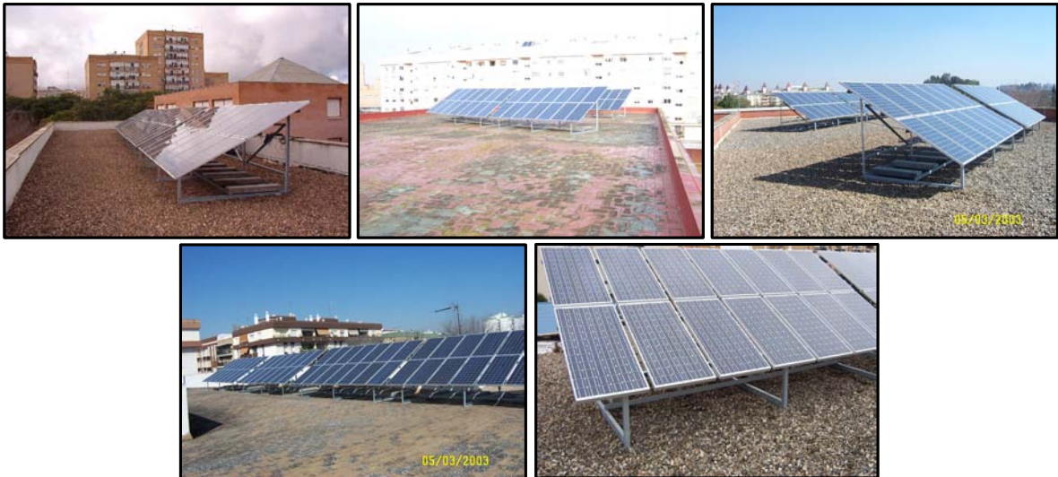
Foto 5. Instalaciones solares conectadas a red de 5 kW, en los colegios del municipio de Sevilla: C.P. Alfonso Grosso, C.P. Almotamid, C.P. Ángel Ganivet, C.P. Arias Montano y C.P. Hermanos Machado, en el proyecto “Sevilla Ciudad Solar”.
