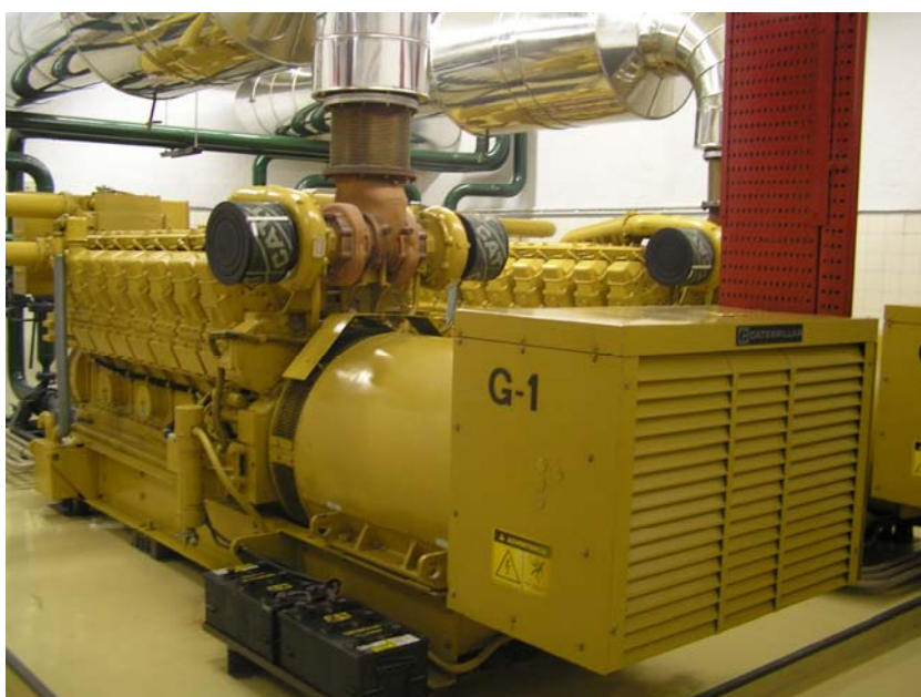
Foto 1. Generadores de energía.
