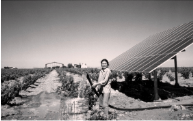
Sistema Fotovoltaicos para bombeo de agua
