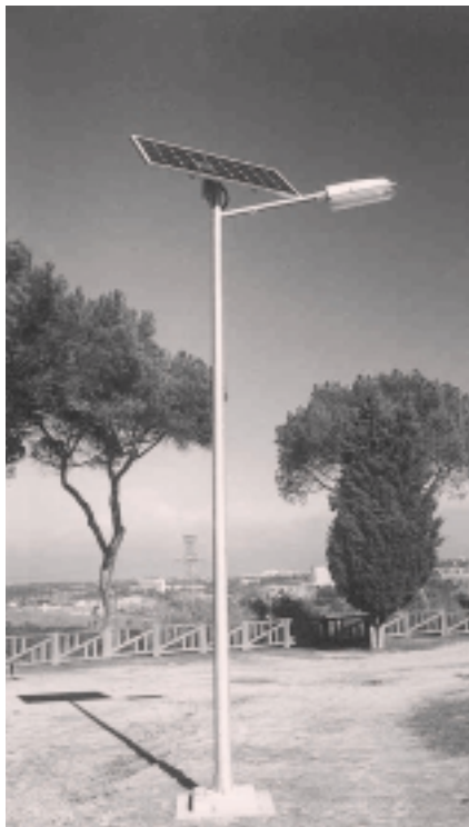
Farola Fotovoltaica en la Casa de Campo
