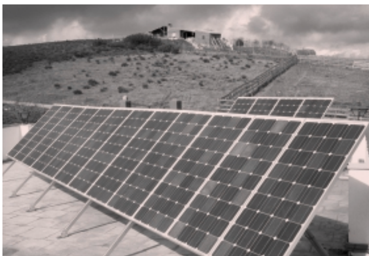
Instalación Fotovoltaica en Arganda del Rey. Madrid
