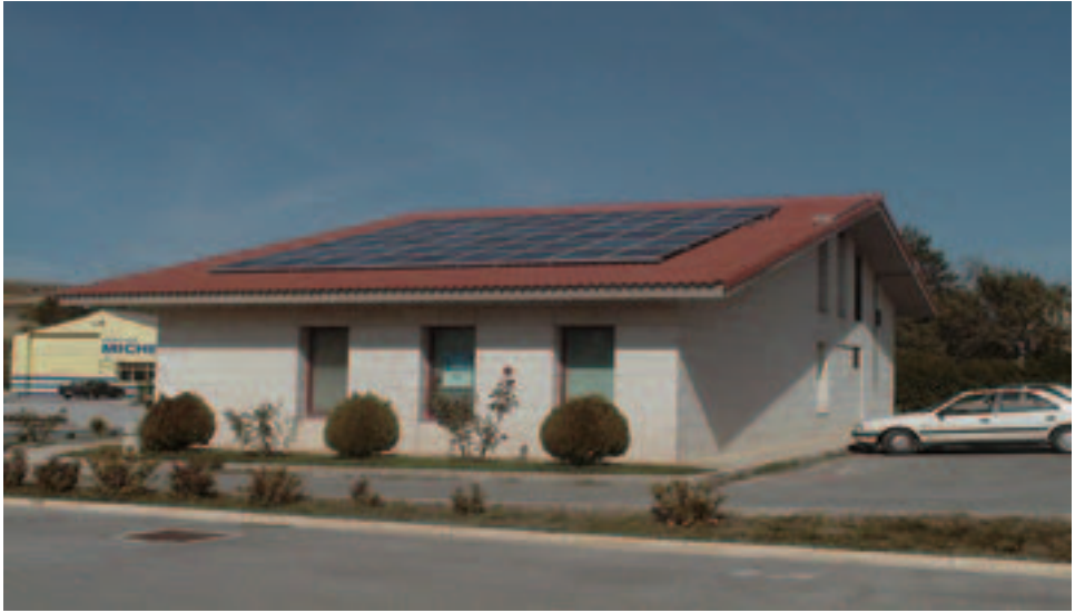
Foto 3. Sistema fotovoltaico sobre tejado inclinado.
