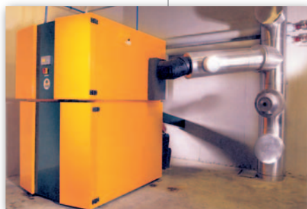
Figura 33: Caldera de pellets de 150 kW.
