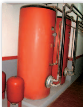
Figura 53: Depósitos de acumulación de ACS.
