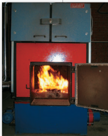
Figura 44: Caldera de biomasa.
