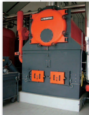
Figura 4: Caldera de biomasa para district heating (850 kW).
