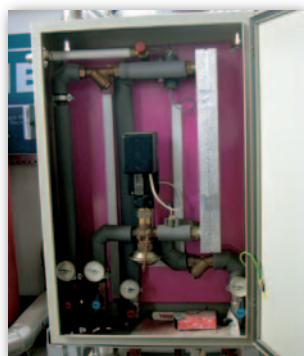
Figura 7: Intercambiador de placas.
