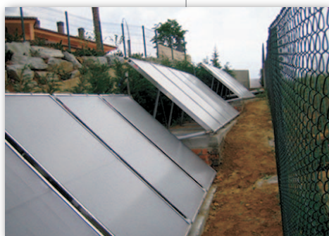
Figura 35: Campo de captadores solares
