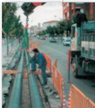
Figura 50: Red de tuberías.
