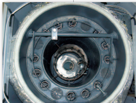
Figura 27: Vista superior del intercambiador de calor.
