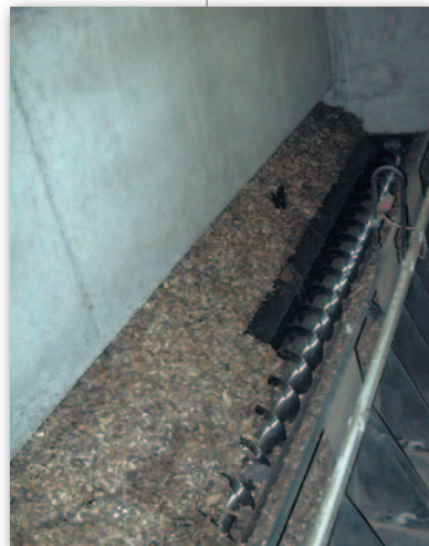
Figura 26: Sistema de alimentación mediante tornillo sinfín.
