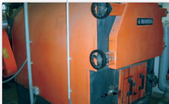
Figura 10: Caldera de biomasa de tamaño medio (250 kW).
