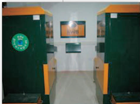
Figura 47: Sala de calderas del Hotel Flamingo.
