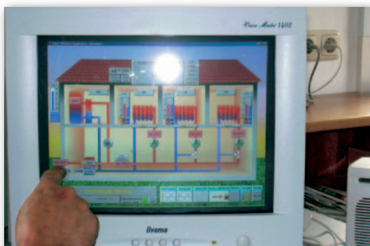
Figura 8: Supervisión del sistema (detalle de vivienda)
